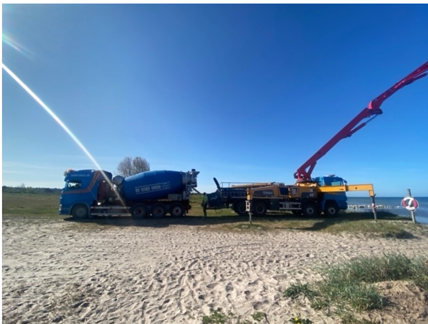
Foto nr. 1 Betong- och Pumpbil placerade ovanför strandkant på något stabilare mark.
